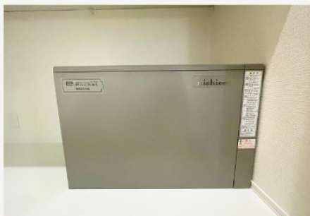
大容量 蓄電池 13.2kWh 万が一の災害に備える。
